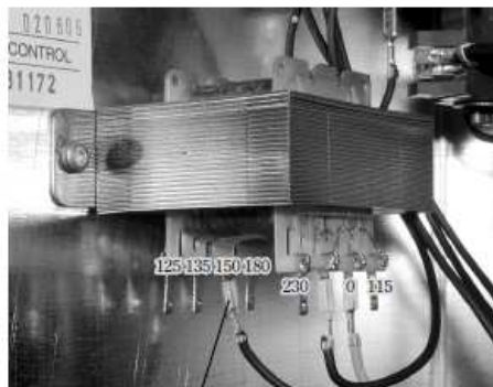
Denna kabel flyttas.
